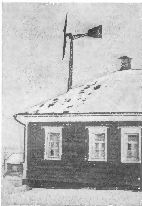
Фиг. 1. Ветроэлектрический агрегат ВД-3.5 мощностью до 1000 ватт, установленный для освещения клуба в колхозе им. 8 Марта, Бронницкого района Московской обл.
